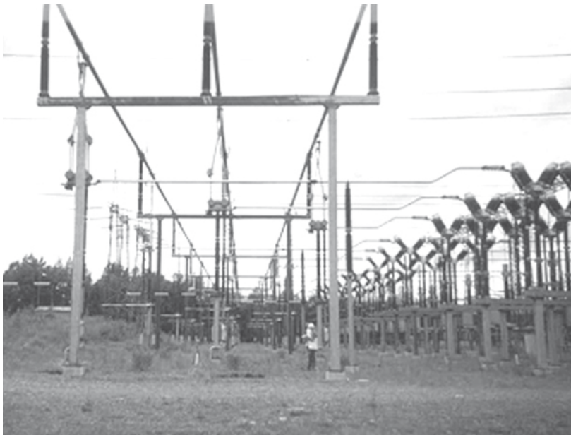
Kuva 9.5 Valokuva 400 kV sähköaseman pääkiskostosta
