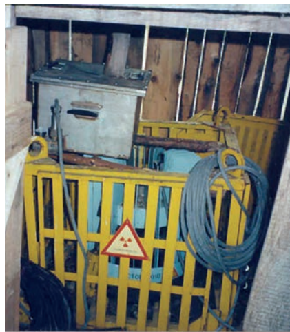
Venäjän alueella Suomenlahdella on noin 70 majakkaa ja merimerkkiä, jotka ottavat tehonsa radioaktiivista strontiumia sisältävästä RTG-laitteista. Kuvan RTG on Saimaan kanavan alueella.
