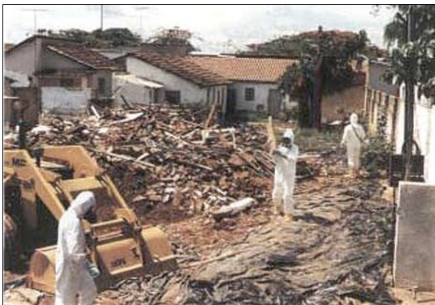
Saastuneita taloja löydettiin yhteensä 85. Seitsemän taloa jouduttiin purkamaan.
